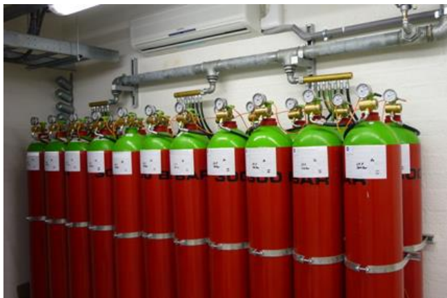
Een inerte blusgasinstallatie
