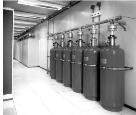
Chemische blusgassen t.b.v. computerruimte
