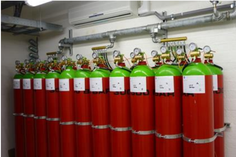
Een inerte blusgasinstallatie
